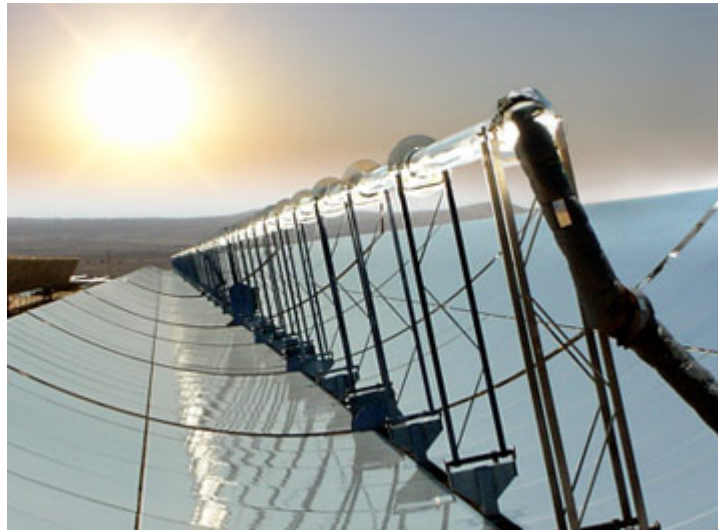
Fig. II.13 - Capteurs cylindro-paraboliques de la centrale Nevada Solar One
