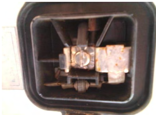
Figure 1.16. Exemple de la corrosion d'un module PV.
