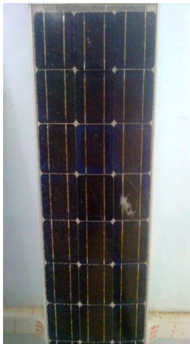
Figure 1.17. Exemple de rupture d'un module photovoltaïque.
