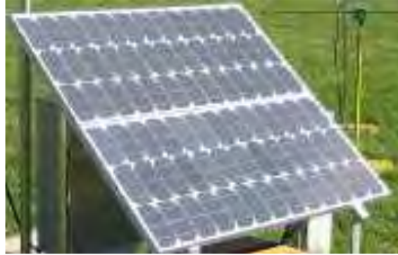
Figure (1-5) : Panneau de solaire [10, 15].
