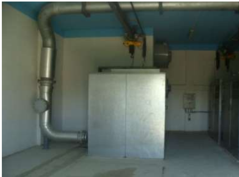
Figure 14: Suppresseurs d'aération de la Station de Sidi Merouane.
