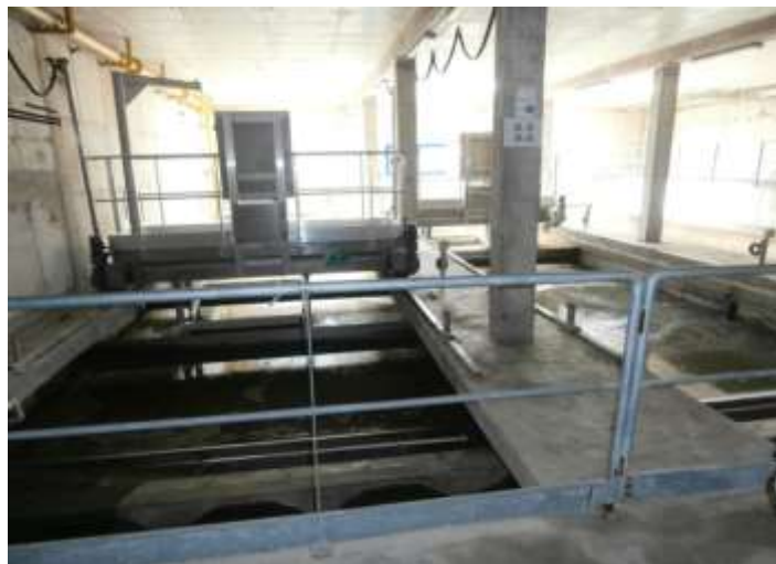
Figure 9: Dessableur, dégraisseur de la station de Sidi Merouane.
