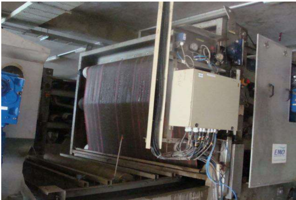
Figure 19: Filtre à bande des boues de la station de Sidi Merouane.
