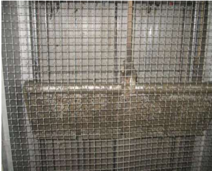
Figure 8: Dégrilleur grossier automatique de la station de Sidi Merouane.
