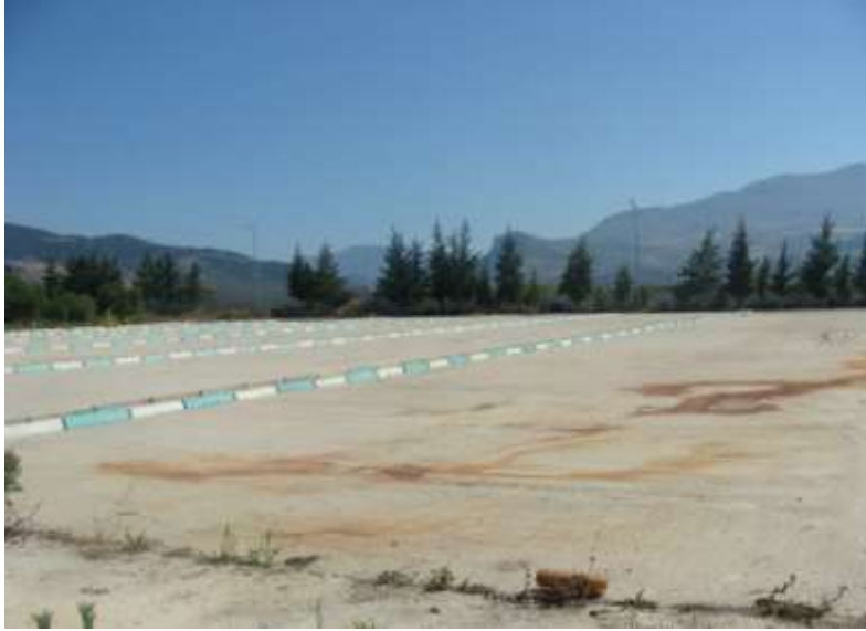
Figure 20: Lits de séchage des boues de la station de Sidi Merouane.
