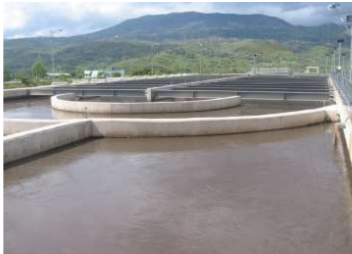
Figure 11: La zone anoxie amont du réacteur biologique de la station de Sidi Merouane.
