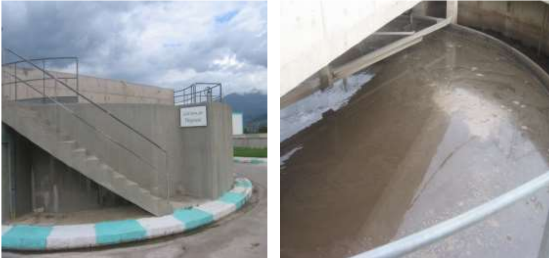
Figure 15: Dégazeur de la station de Sidi Merouane.
