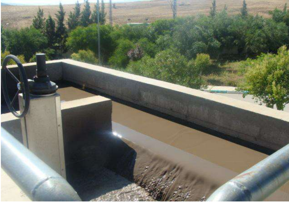
Figure 17: Recirculation des boues dans la Station de Sidi Merouane.
