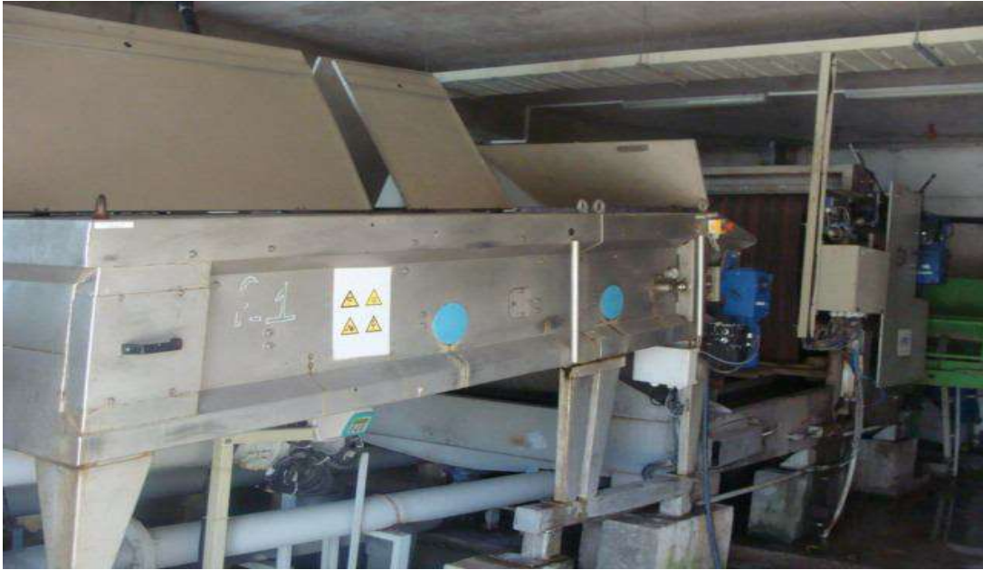
Figure 18: Table d'égouttage des boues de la Station de Sidi Merouane.
