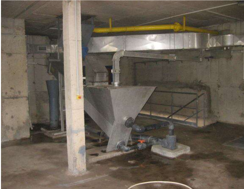
Figure 10: Désodoriseur biologique de la station de Sidi Merouane.
