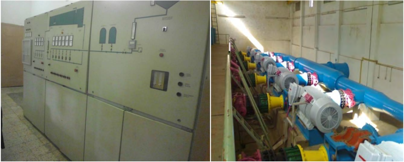
الصورة رقم 10: محطة الضخ وقاعة التحكم بمحطة قطاع بومهرة أحمد
