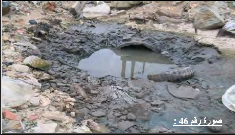
إنكسارات في شبكة الصرف الصحي
