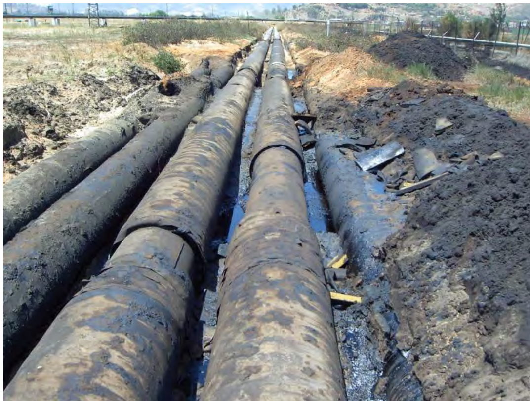
Photo 5. La corrosion des pipes qui ont causé la pollution.
