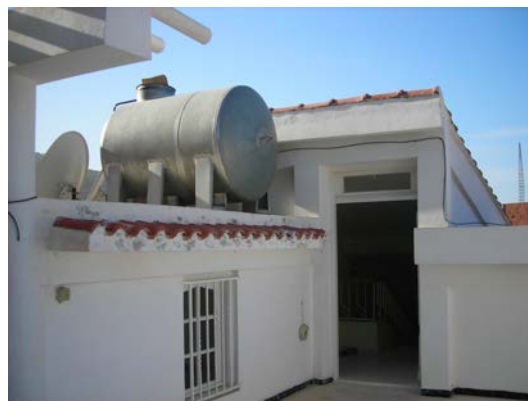
Citerne d'approvisionnement d'eau installée au dernier niveau
