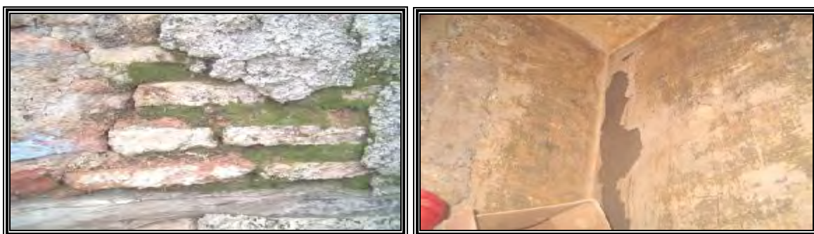
Fig.3.14 : Éclatement du mortier après gonflement Source : auteur, 2005
