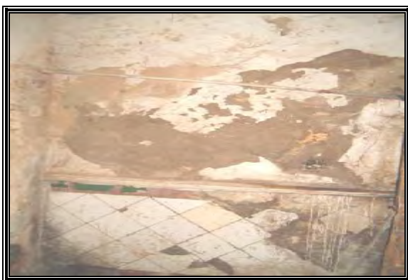
Fig. 3. 36 : Détérioration des revêtements intérieurs
