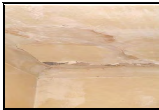
Fig.3.5 : Infiltration directe par le toit.
