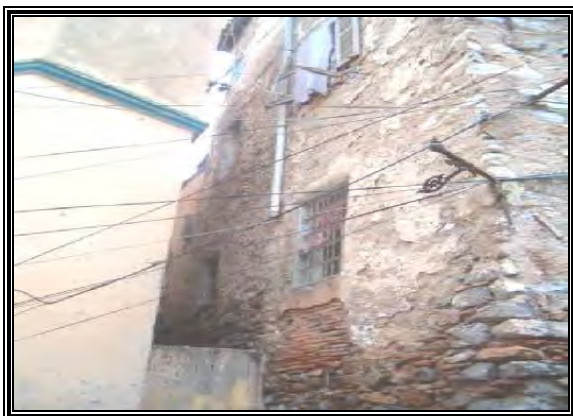
Fig. 3. 34 : immeuble dégradé, quartier Suika
