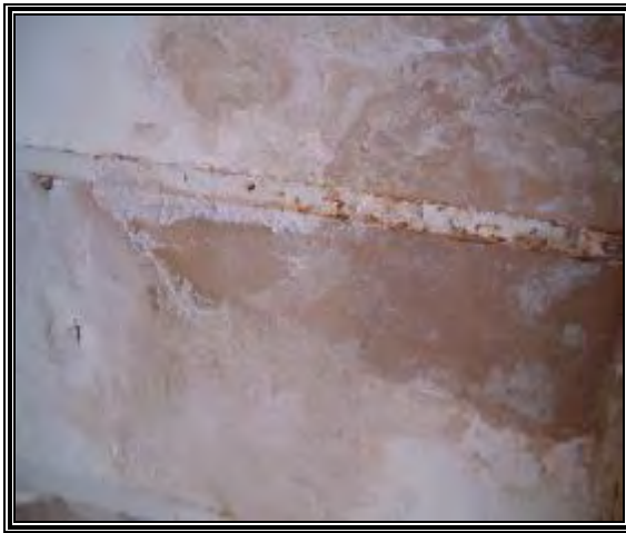
Fig. 4-7 : condensation provoquée par l'air tellurique
