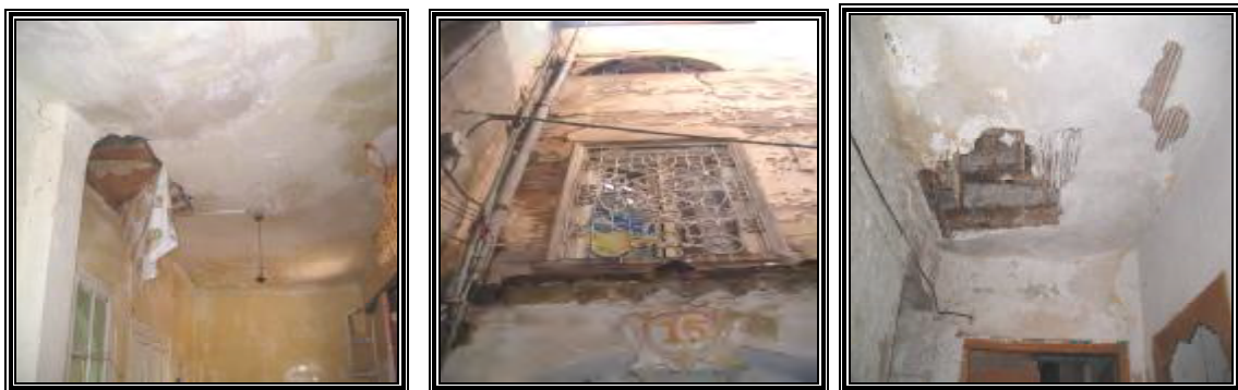
Dégradation du faux plafond causée par la détérioration de la tuile Effet des pluies battantes sur la façade d'accès (N-O) Détérioration provoquée par une mauvaise étanchéité du carrelage
