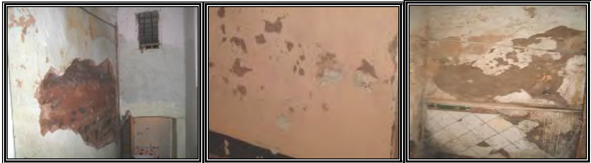
Érosion profonde de l'enduit (Mur mitoyen des ruines) dégradation superficielle de l'enduit Apparition d'efflorescences fig.6-83 : effet de l'humidité ascensionnelle. Source : auteur, 2005.
