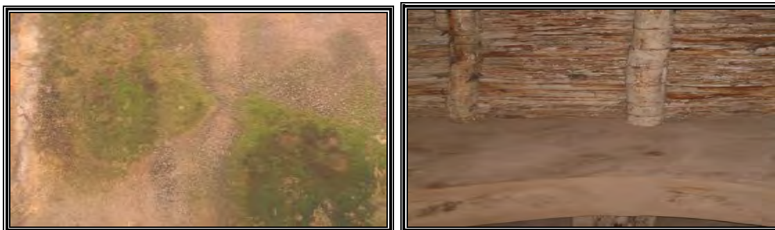
Moisissures sur mur extérieur de l'impasse (Preuve d'un manque de ventilation et d'ensoleillement)
