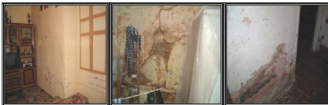
Remonté capillaire (chambre),
