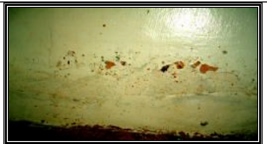
Fig.3.20 : Écaillage de la peinture. Source : auteur, 2005
