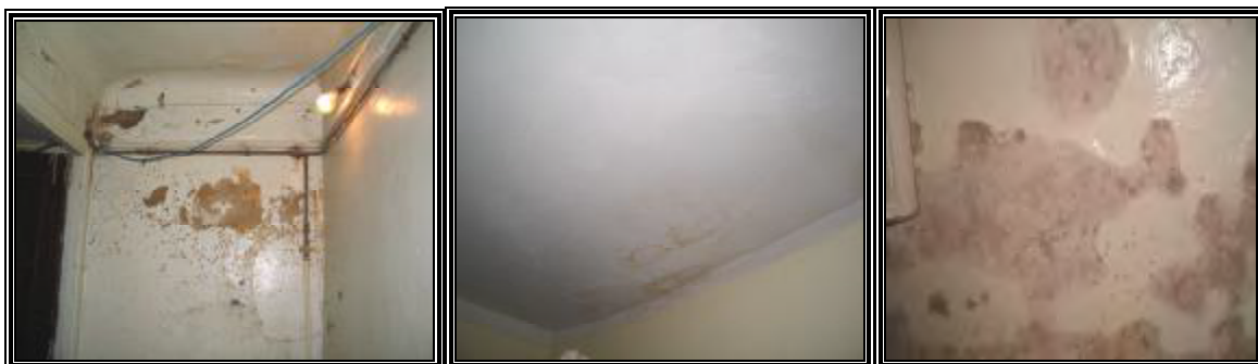
Érosion de l'enduit
