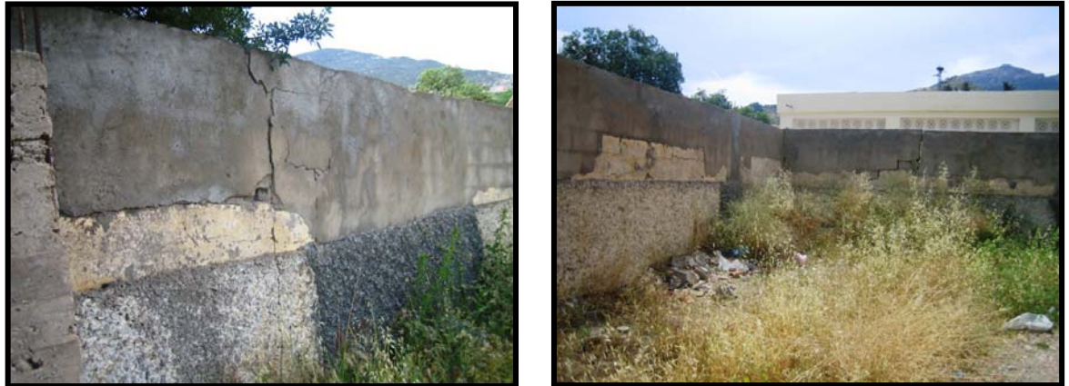
Fig. IV.4: Dégradations au niveau de la clôture du CEM
