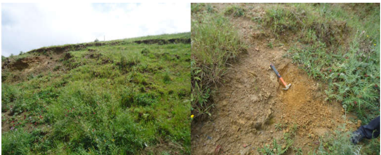
Photo III.6: Glissement de terrain affectant les formations de l'Eocène inférieur-moyen : marnes argileuses noires à rognons calcaires jaunes. C'est le point de prélèvement de l'échantillon 02 ; 7°52'24,29"E et 36°9'15,38" / RN 81B ; PK 2+900.
