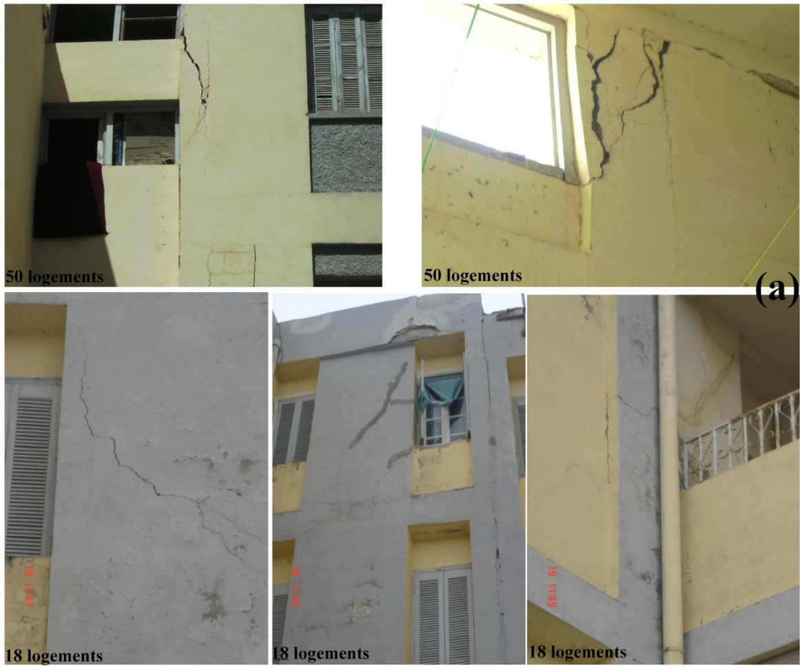
Figure 50 (a). Photos montrant l'état actuel des quelques constructions dans la région d'études (Commune d'El Kouif) : manifestation du retrait- gonflement sur les murs.
