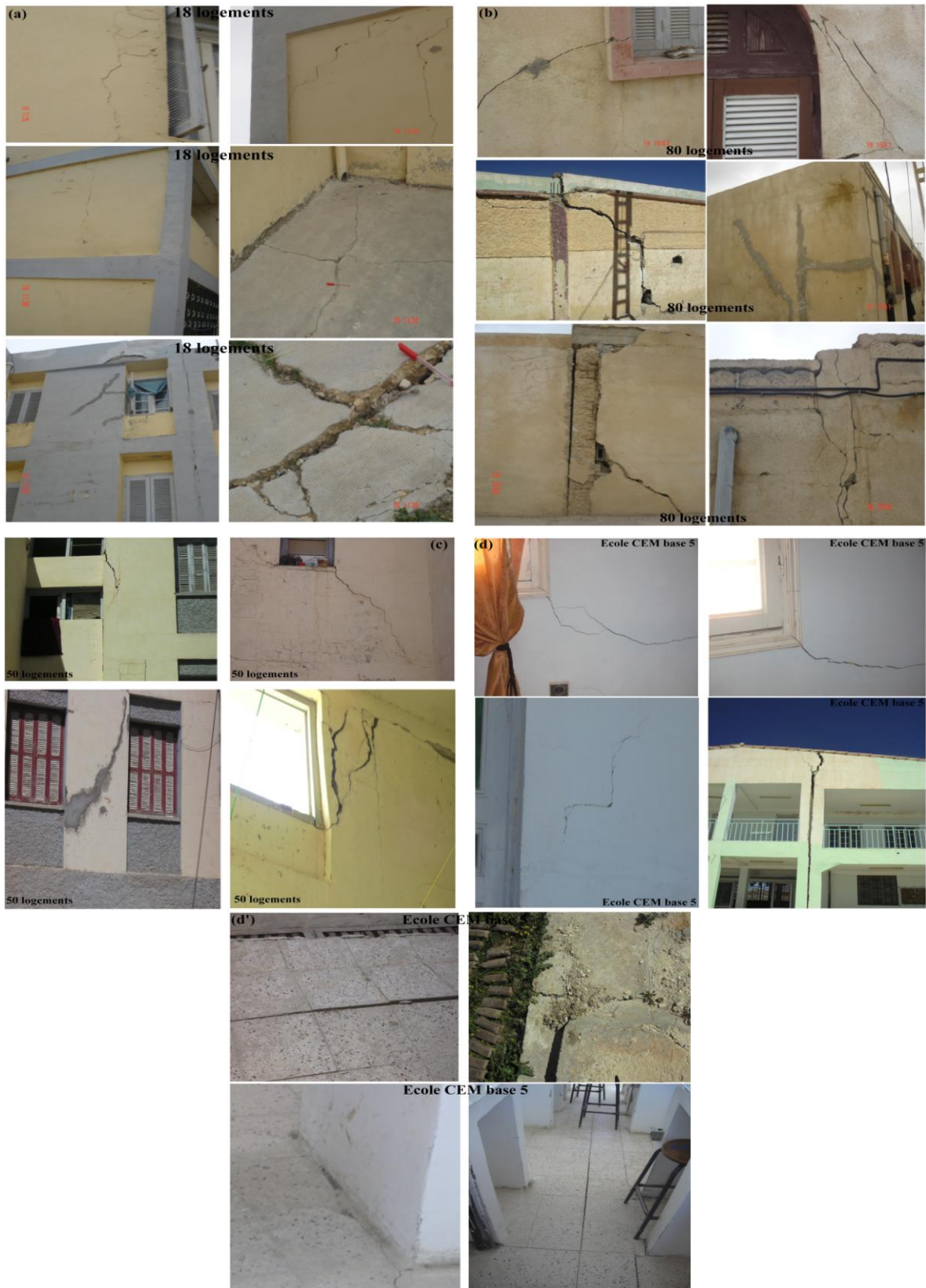
Photos 1. Photos montrant l'état des différents dégâts dans la région d'étude (a) : 18 logements ; (b) : 80 logements ; (c) : 50 logements ; (d) et (d') : école CEM base 5
