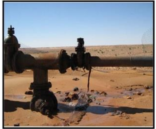
الصورة رقم(30): تسريبات في شبكة التزويد بالمياه 2012
