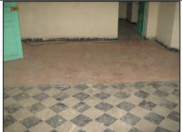
photos 131, reprise du carrelage détaché par un plus récent.
