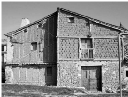
Figure 93 Etat vétuste d'une construction en terre ancienne, en Espagne
