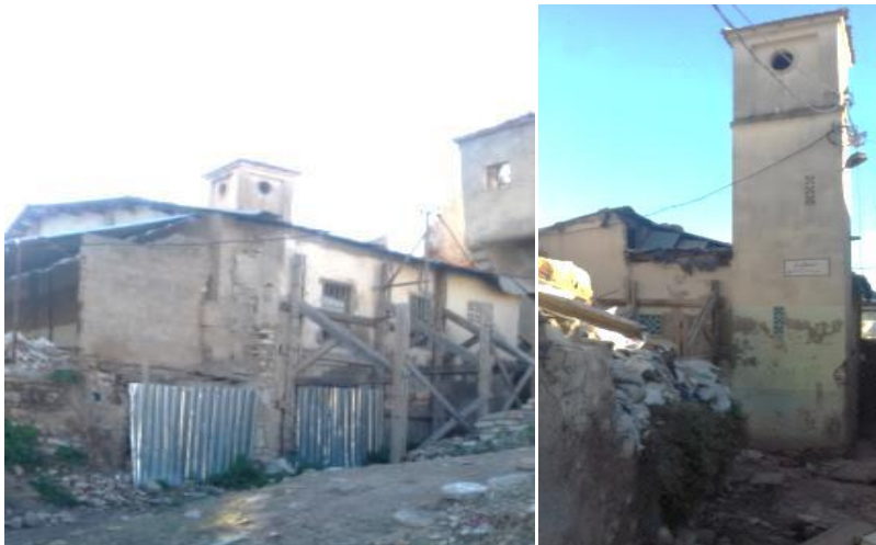
Photo n°45 : Mosquée Bouabdellah Chérif (Aissaouia) abandonnée par l'entreprise de réhabilitation.
