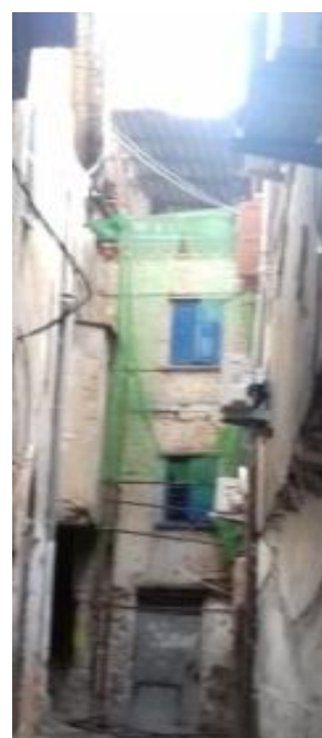
Photo n°54 : Etat d'une zaouia abandonnée par l'entreprise de réhabilitation (événement 2015).
