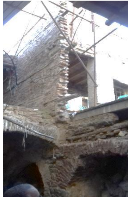
Photo n°28 : état en ruine de la maison après la tentative de réhabilitation par la cellule de sauvegarde.
