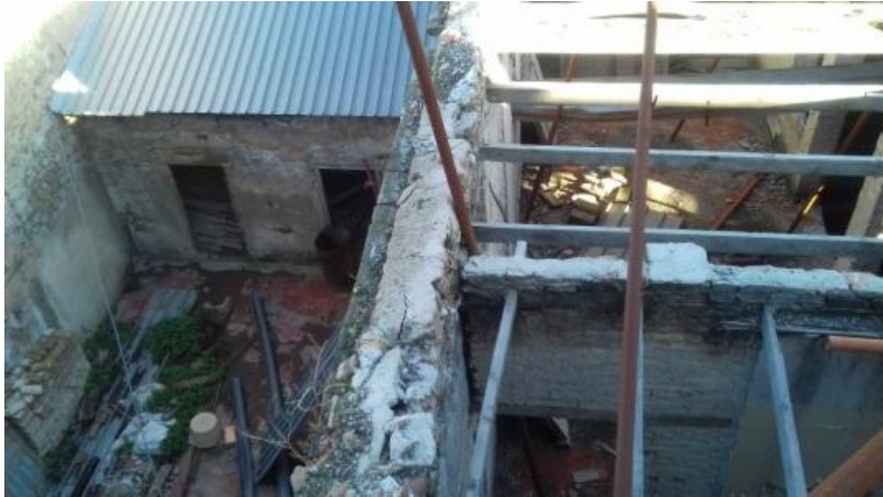
Photo n°49 : Vue plongeante sur l'état actuel d'une maison avec un hamam n°13 de la rue Sidi Nemdil abandonnée par l'entreprise de réhabilitation (événement 2015)
