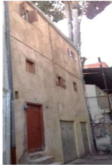
Photo n°67 : Maison n°4 de la rue Bouhala Amar refaite par son propriétaire au style traditionnel Source : Auteur 2019
