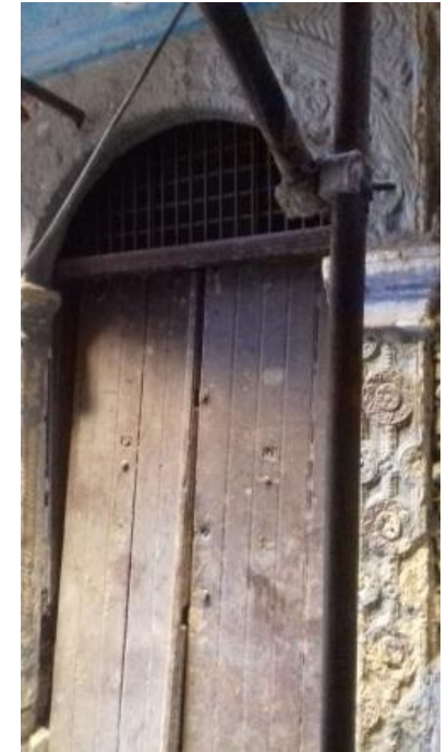
Photo n°29 : état de la porte de la maison.
