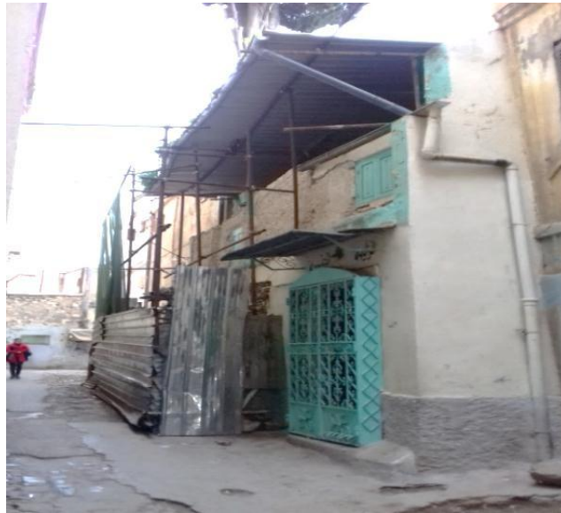
Photo n°48 : Etat de la zaouïa Taibia abandonnée par l'entreprise de réhabilitation
