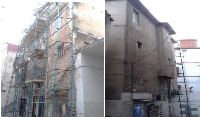
Photo n°79 : Maison n°19 de la rue Boursas Nouar en cours de réhabilitation par son propriétaire
