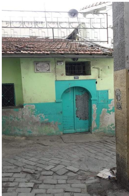
Photo n°50 : Etat de la mosquée Saida Hafsa abandonnée par l'entreprise de réhabilitation (événement 2015).
