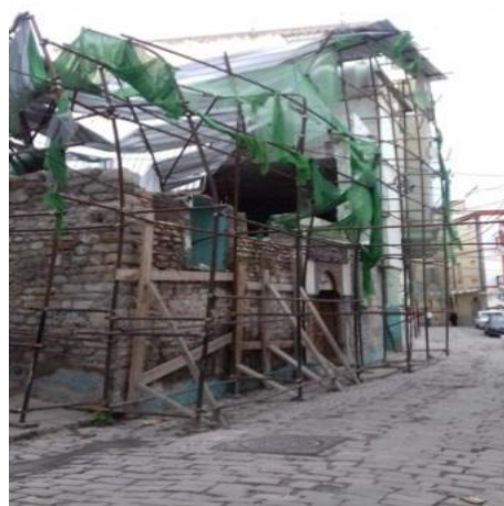
Photo n°52 : Etat de la mosquée Rabaine Chérif (événement 2015). Source : Auteur 2019.
