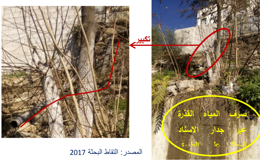
صورة 26 ربط عشوائي لشبكة الصرف الصحي بحي بن تليس
