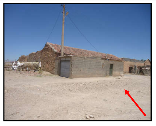
الصورة رقم (13): مساكن في حالة رديئة
