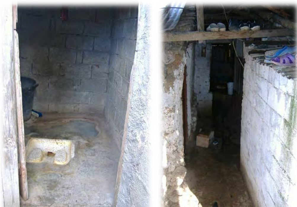
Photos n°40/41 : Les WC qui se transforment en douche. Il faut traverser un corridor sombre pour pouvoir accéder à ce lieu d'aisance. L'auteure 2010
