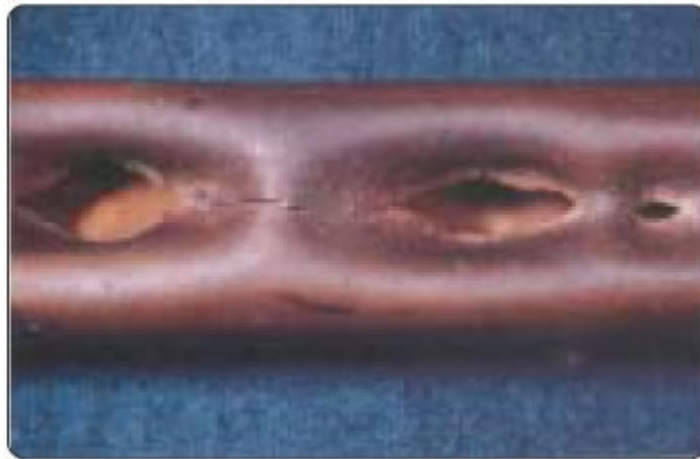
Figure 1-11 : Tube endommagé par effet de marteau par la vapeur d'eau [1]
