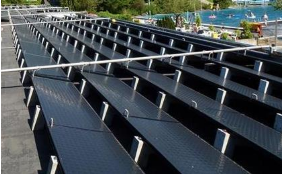
Fig. I.6 Capteurs solaires plans sans vitrage (Piscine Sijsjesberg « Energie Solaire ») [4].
