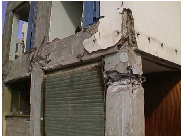
Fig. 3.11: Endommagement d'un portique dans une maison lors du séisme de Boumerdès en 2003.
