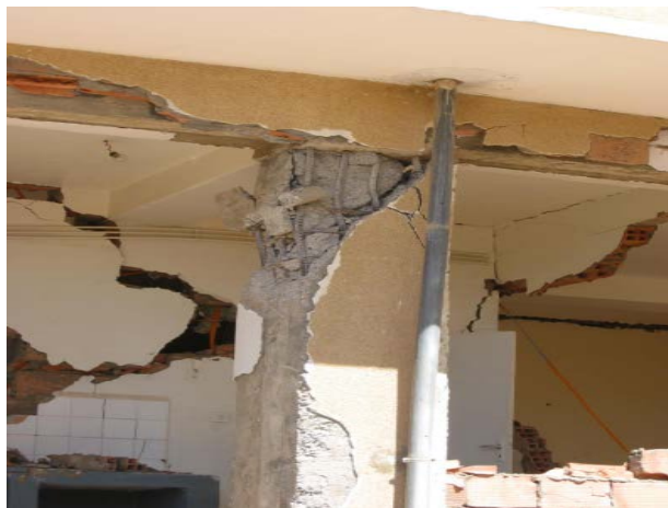
Fig. 3.6: Rupture par cisaillement d'un poteau en béton armé dans un logement lors du séisme de boumerdès en 2003.
