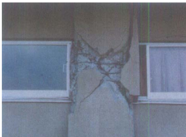
Fig. 3.9: Rupture par cisaillement d'un poteau court en béton armé dans une école d'enseignement technique des chemins de fer lors du séisme de Miyagi-Ken en 1978.
