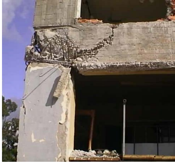
Fig. 3.10: Endommagement d'un nœud poteau-poutre par cisaillement lors du séisme de Boumerdès en 2003.
