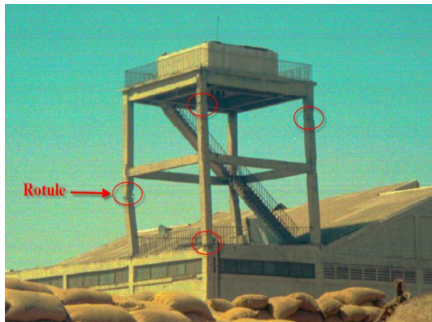
Fig. 3.5: Endommagement d'un portique à 2 étages par flexion dans les zones critiques des poteaux dans une installation portuaire lors du séisme de Buhj (Inde) 2001.
