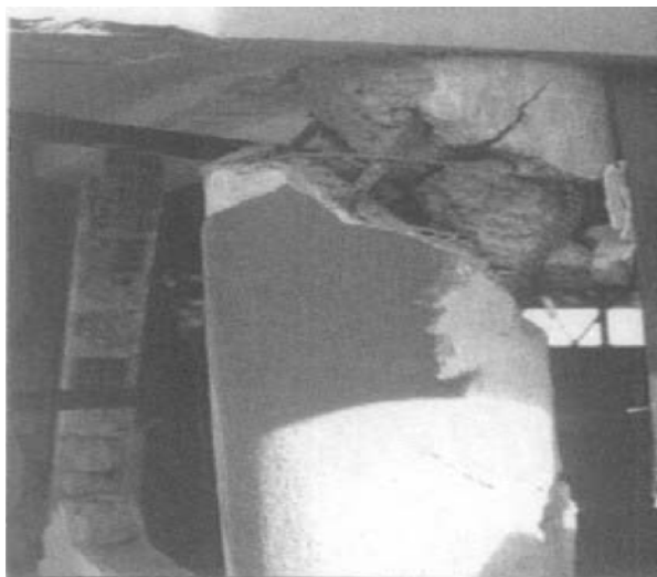
Fig. 3.8: Rupture par cisaillement d'un poteau en béton armé lors du séisme de Kalamata (Grèce) en 1986.
