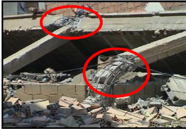
Fig. 3.4: Exemple de dommages d'un bâtiment suite au séisme de Zemmouri 2003.
