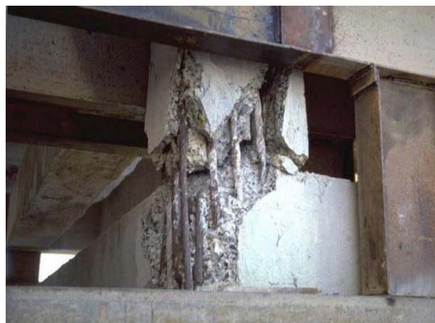
Fig. 3.12: Ruine d'un nœud à la jonction poteau-poutre d'angle lors du séisme de Buhj (Inde) en 2001.
