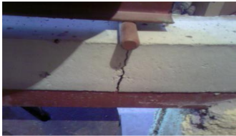
Photo 3. Fissuration de la poutre
