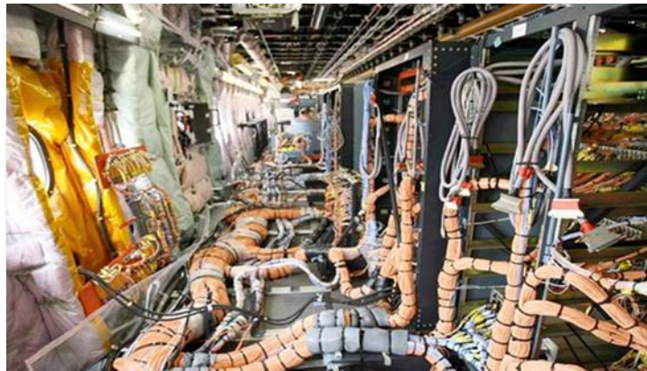
Figure 1.14: Réseau filaire d'un avion [2].
