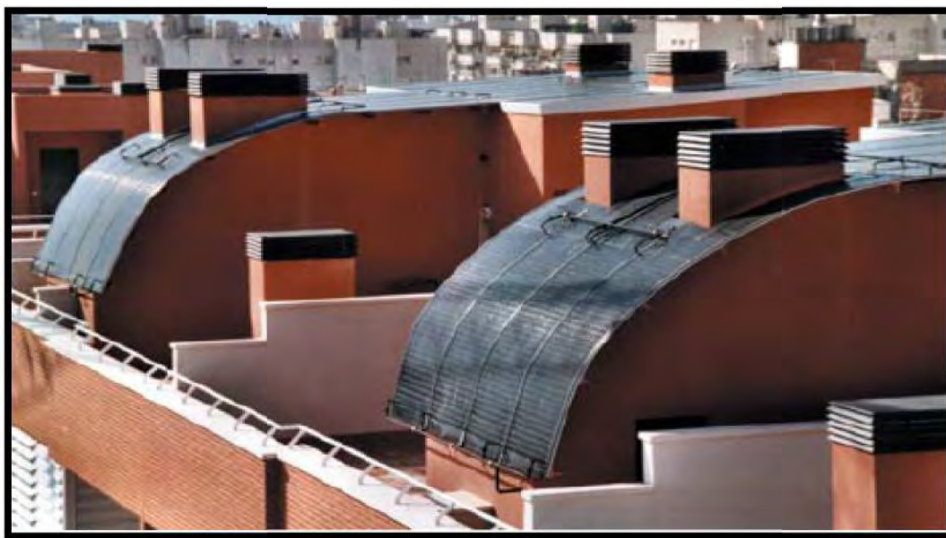
Figure 3.3. Installation de production d'eau chaude sanitaire, Energie Solaire SA
