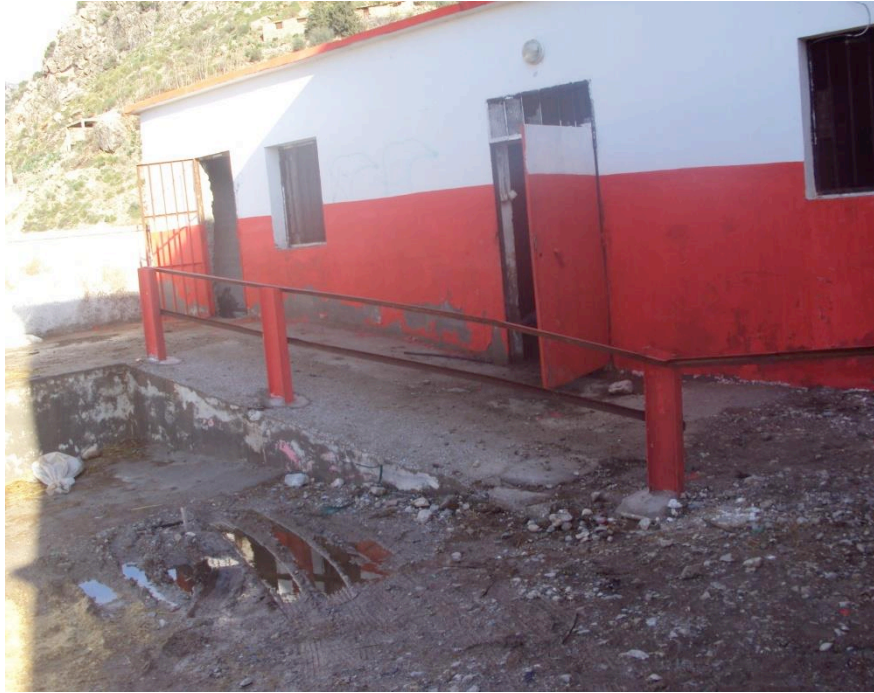
Figure 23 : La ferme de l'abattoir de Kherrata et couloir d'amenée des animaux à la salle d'abattage (Photo personnelle)
