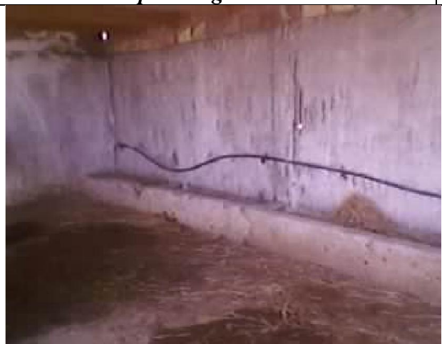
Photo 5.5: Système de tuyauterie pour abreuvement
