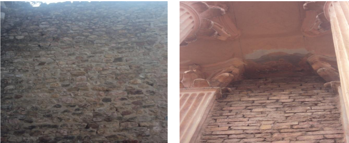
الصورة ب : تسرب المياه إلى سقف مدخل المسرح بالإضافة إلى تصدع الجدار الخارجي .
