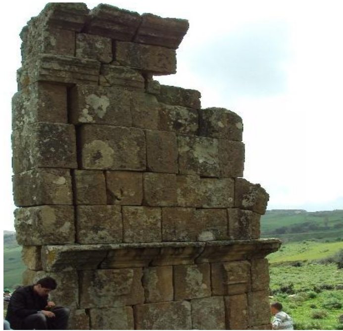
الصورة ج : تآكل بوابة الشرق (قوس النصر) .
