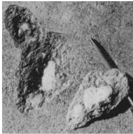
FigureI.5 : Eclatement et délamination du béton [Mosser 2004].
