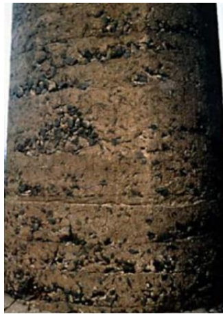
FigureI.7 : Abrasion en pied de pile d'un pont franchissant une rivière [Mosser 2004].
